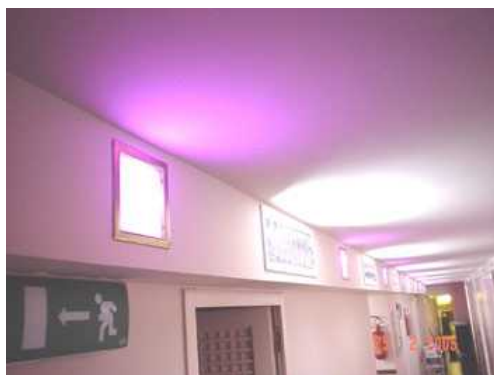
Sistema Cromatico installato in un corridoio con sorgenti fluorescenti full spectrum incassate
